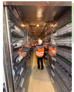
Großer Batteriespeicher auf Basis von alten Autobatterien Bild WBSK
